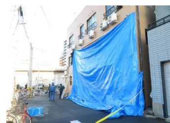
【火災現場 (ブルーシート設置)】
