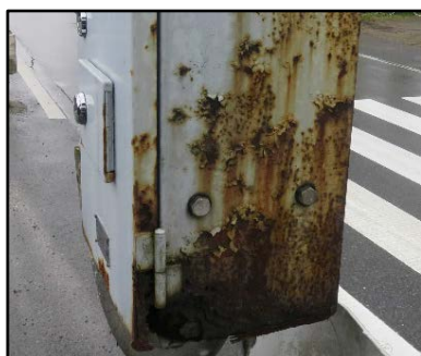
【腐食した信号制御機】
