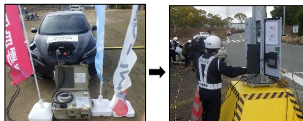
【外部電源による信号機への電源供給】
