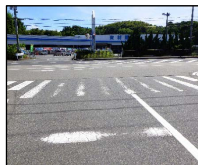
【摩耗した横断歩道】
